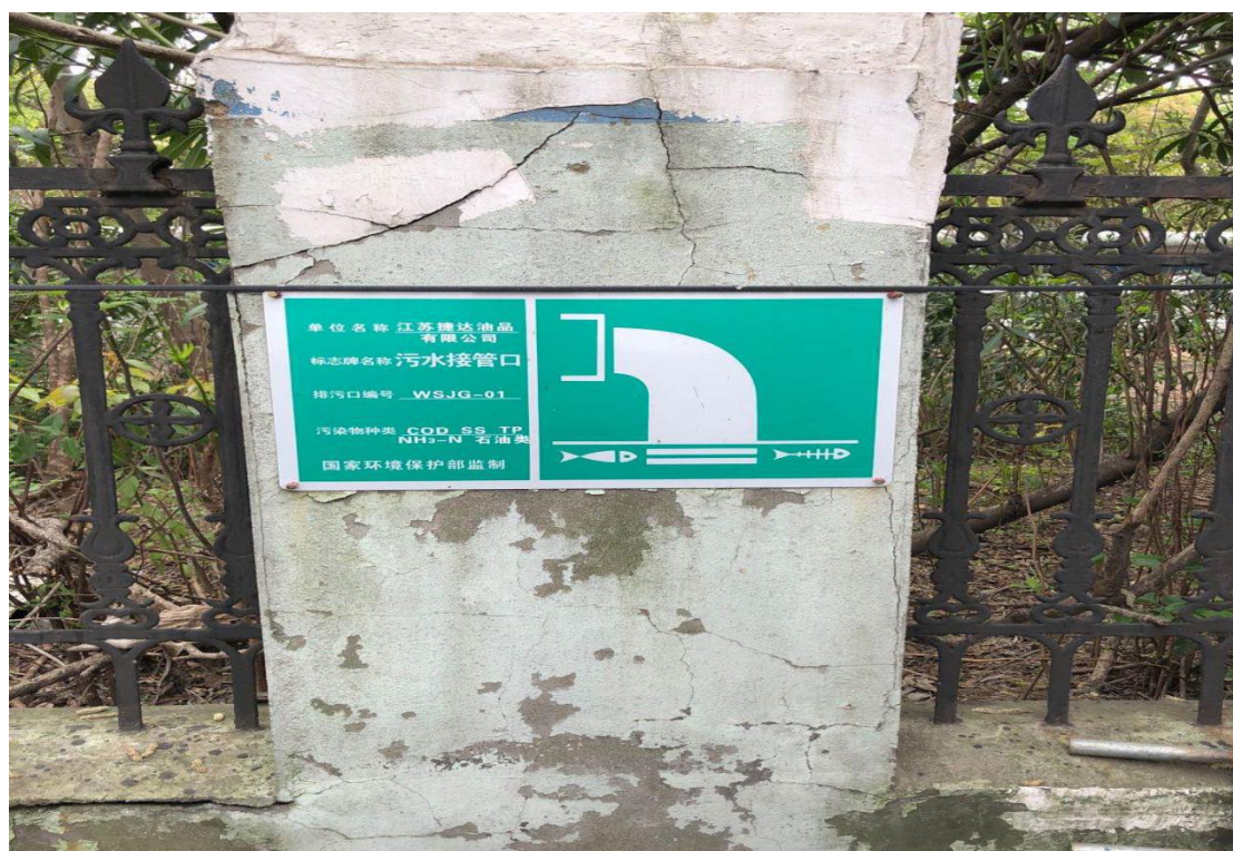
图 4-1 生活污水接管口
