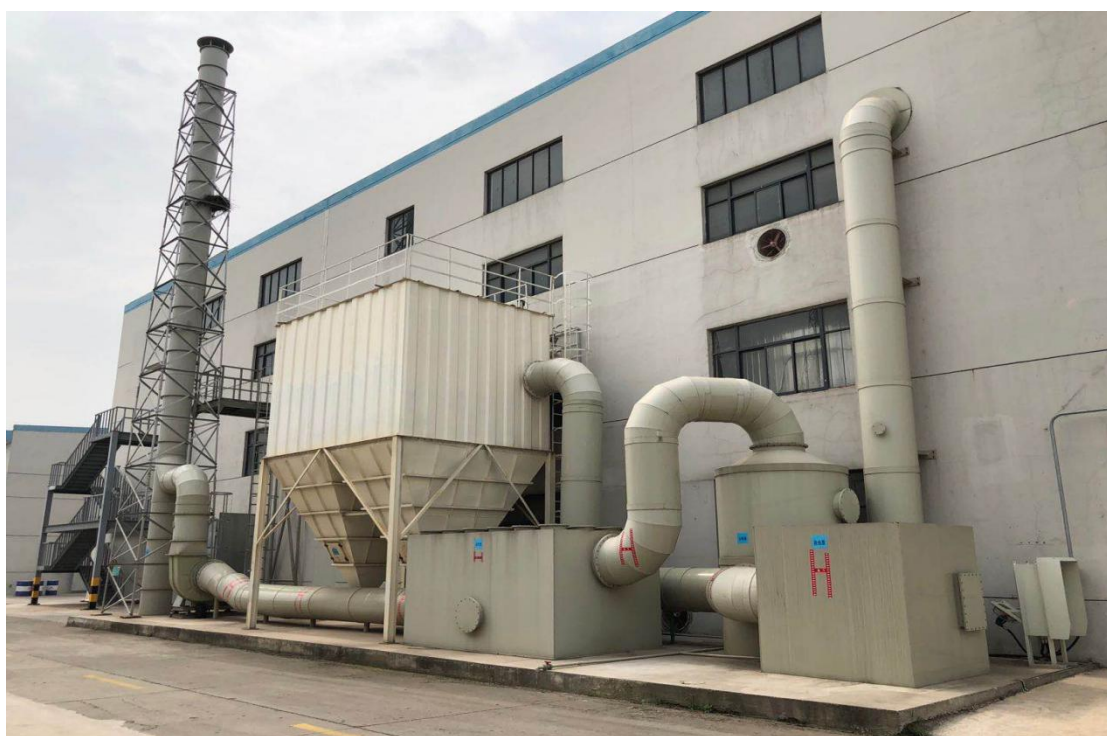
图 4-2 废气处理设施（1#排气筒）
